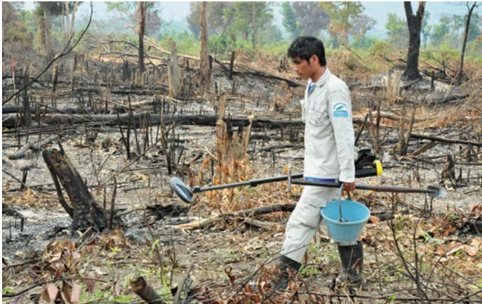
Das Team von Handicap International entmint ein Gebiet in Laos, auf dem bald eine weiterführende Schule erbaut werden soll. – © Till Mayer / Handicap International
